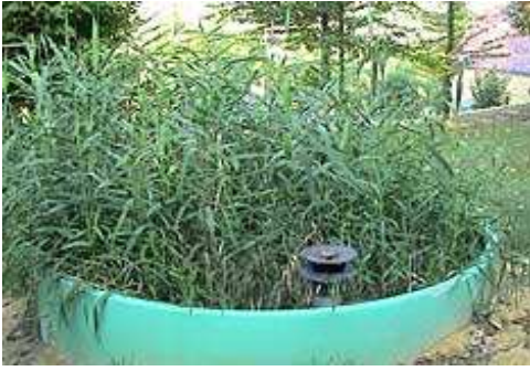
Filtre planté de roseaux
